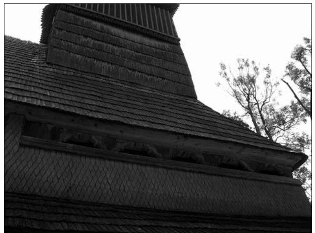
Іл. 8. Покриття гонтом та шинглями (фрагмент). Друга половина XX ст. Церква Різдва Пресвятої Богородиці XVIII ст., с. Пилипець Міжгірського р-ну Закарпатської обл. Світлина Олега Болюка
